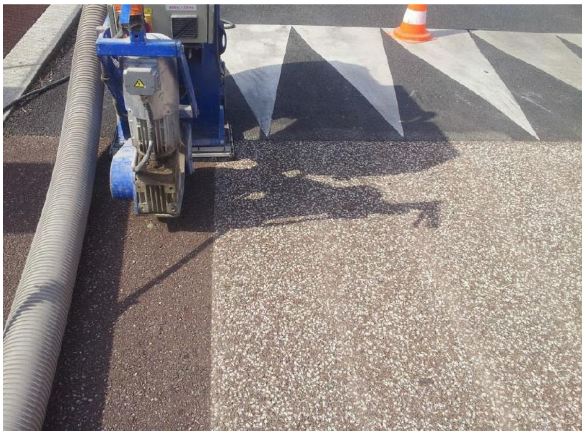
Photo 7. Grenailage du revêtement en enrobé et apparition des agrégats de couleur blanche
