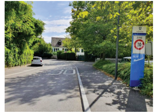
Photo après les travaux de réaménagement réalisés sur le chemin des Gravieres et le chemin Hubert-Saladin
